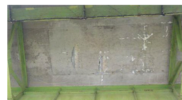
床版下部損傷状況
