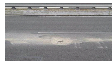
橋の劣化に起因する路面の損傷
